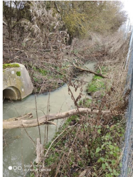
Figure 36 bv4 : Connexion de l'ouvrage D500 et du fossé de remblai (réf : 2020-02-05_14-34-35)
