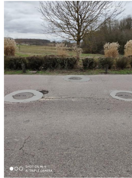
Figure 30 bv3 : Réseau pluvial à l'aval ZAC (point-bas)(réf : 2020-02-05_17-06-52)
