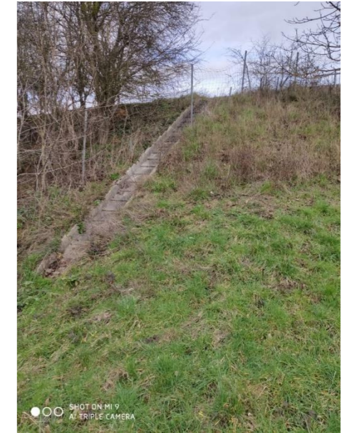
Figure 33 bv3 : Descente d'eau du passage inférieur delà RD (réf : 2020-02-05_15-14-13)
