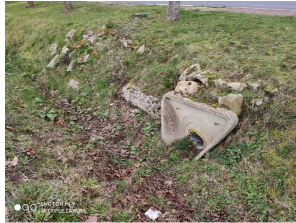
Figure 16 bv1 : Vue du D300 PVC dans le fossé amont de la RD (ref : 2020-02-05_17-38-10)
